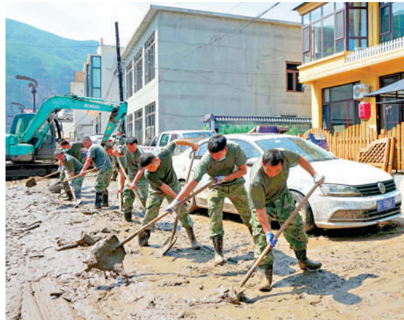
▲受颱風「杜蘇芮」影響，河北省涞水縣早前遭遇暴雨，部分村莊交通、通訊受阻，當地積極搶修重建。 新華社
