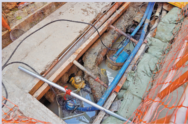
▲環保署表示，在荃灣西海濱雨水渠出水口，共發現70宗污水渠錯駁個案，當中27宗已修復。大公報記者林少權攝
