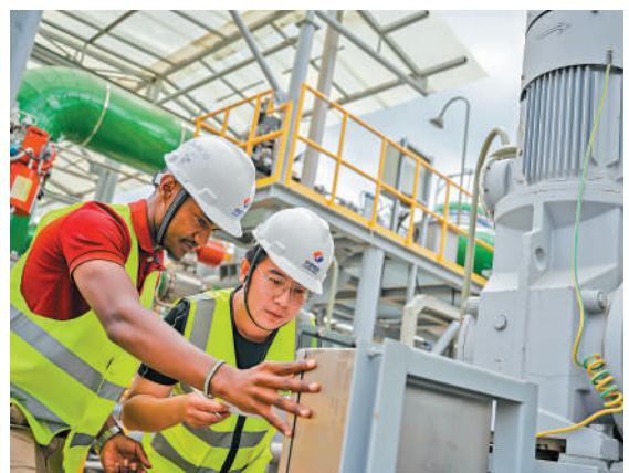
▲中企響應「一帶一路」倡議，助力肯尼亞加快推進能源轉型。圖為施工人員在肯尼亞地熱電站建設現場檢查發電設施。新華社
