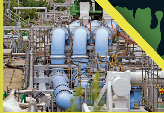
▼福島第一核電站排放核污水的管道設施。美聯社
