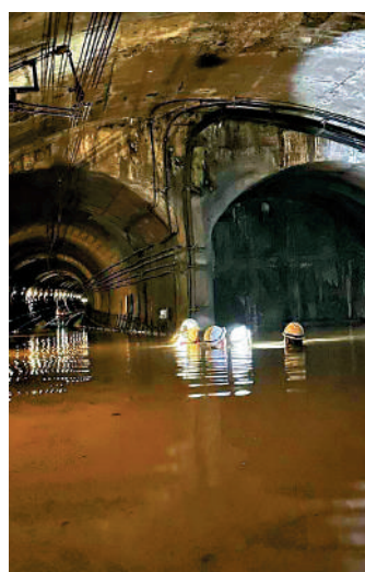
▲港鐵職員進入水浸的隧道善後，可見當時積水已浸至頸部。
