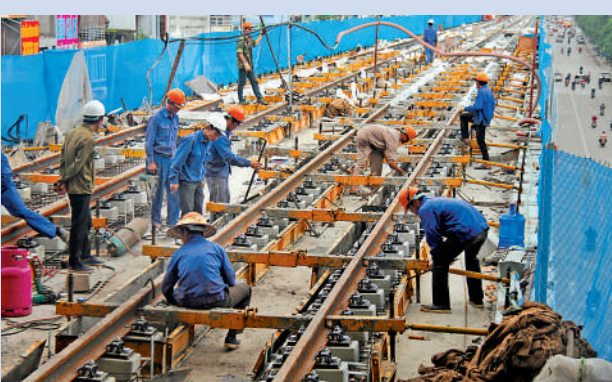
▲施工人員在越南首都河內吉靈—河東線城鐵施工現場作業。新華社
