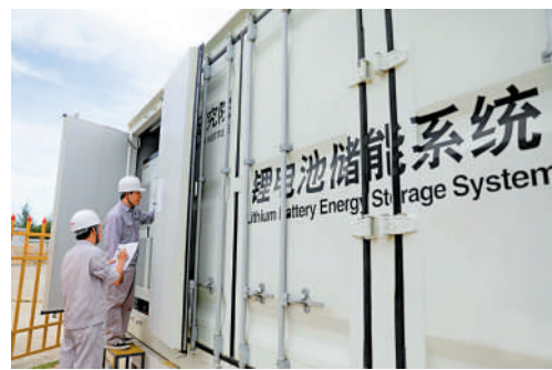
▲在廣東揭陽，工作人員對鋰電池儲能櫃進行巡檢。
