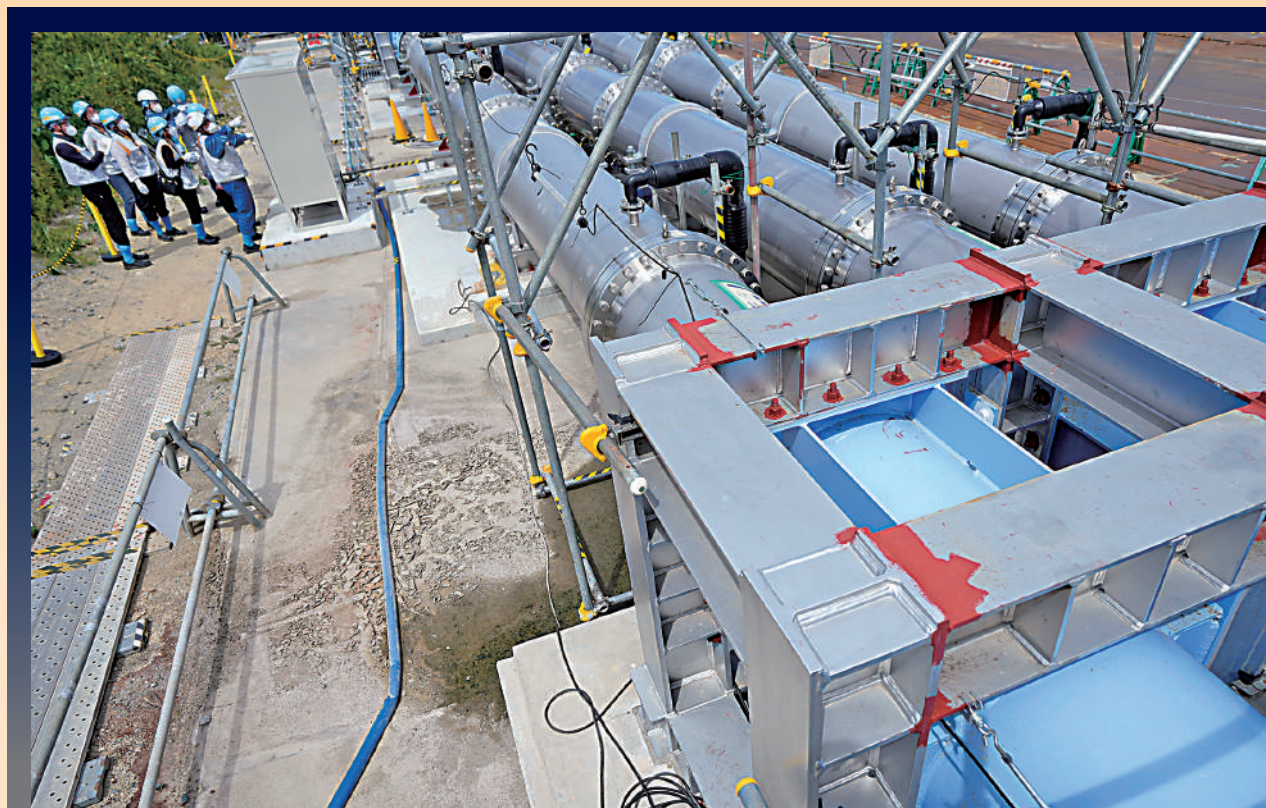
▲福島核污水排放設施內一條運輸海水的管道。美聯社
