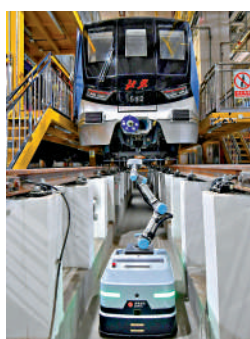
列車智能巡檢機器人在京港地鐵17號線次渠南停車場工作。
