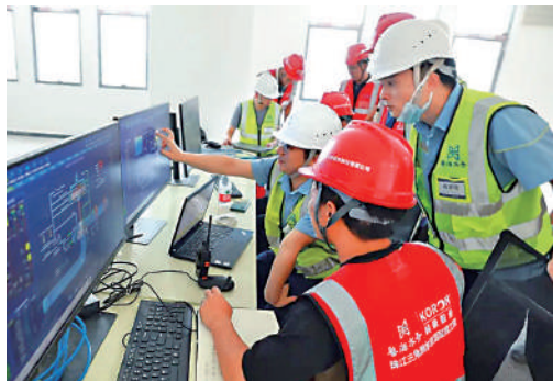
▲工程人員調試高新沙泵站三號機組。
