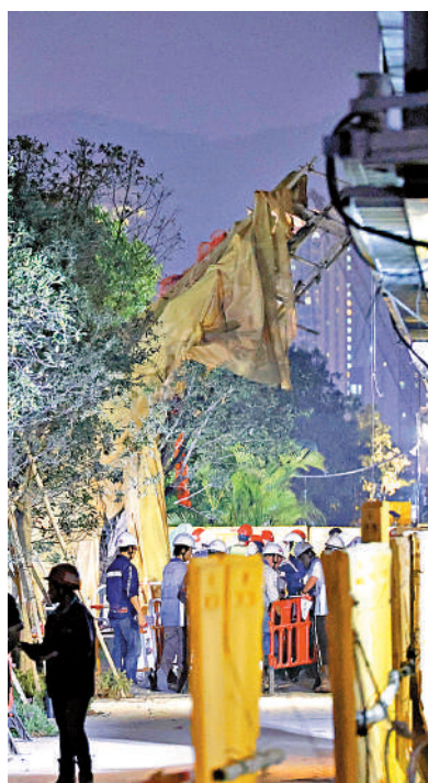
出事棚架從接近20樓高處塌下來。
