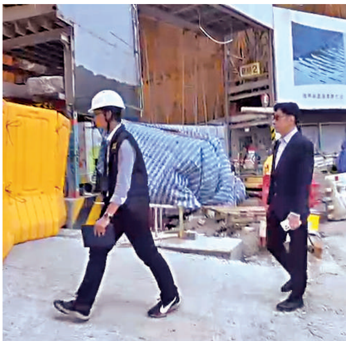
▲警方重案組及勞工處人員，到場棚架意外地盤調查。
