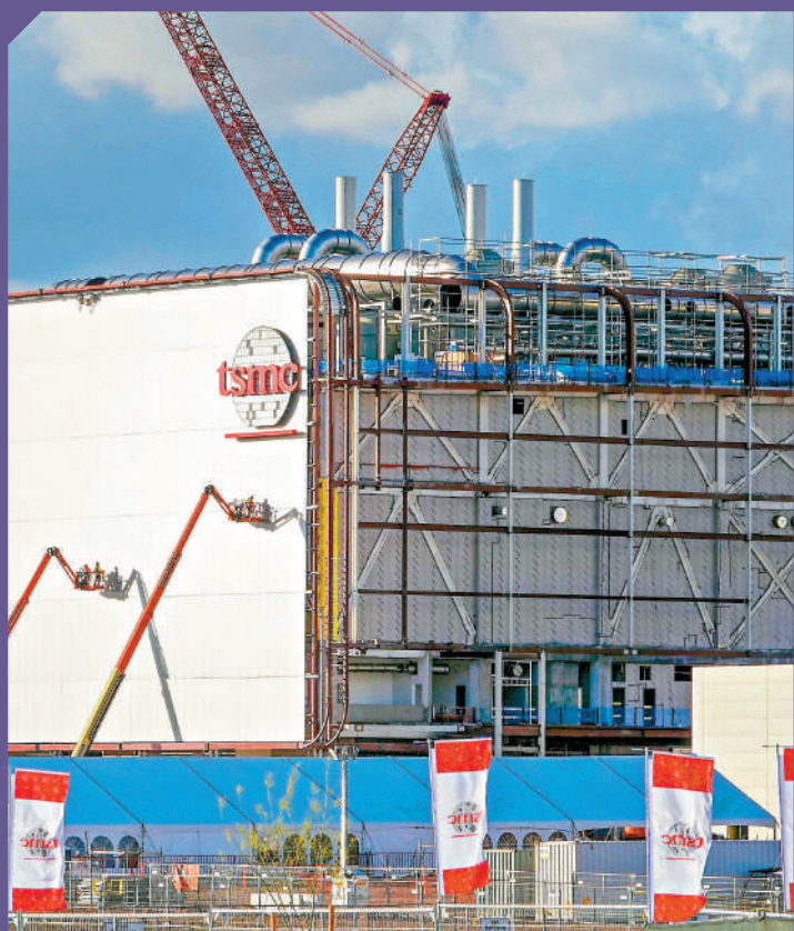
▲由於熟練勞動力短缺，台積電已將美國亞利桑那州新廠的投產時間由2024年推遲至2025年。圖為建設中的台積電亞利桑那州廠。資料圖片
