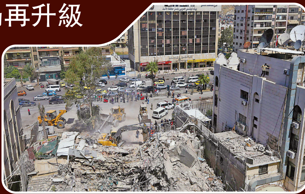
◀ 救援人員2日在伊朗駐敘利亞大使館領事處大樓廢墟中展開搜救。法新社
