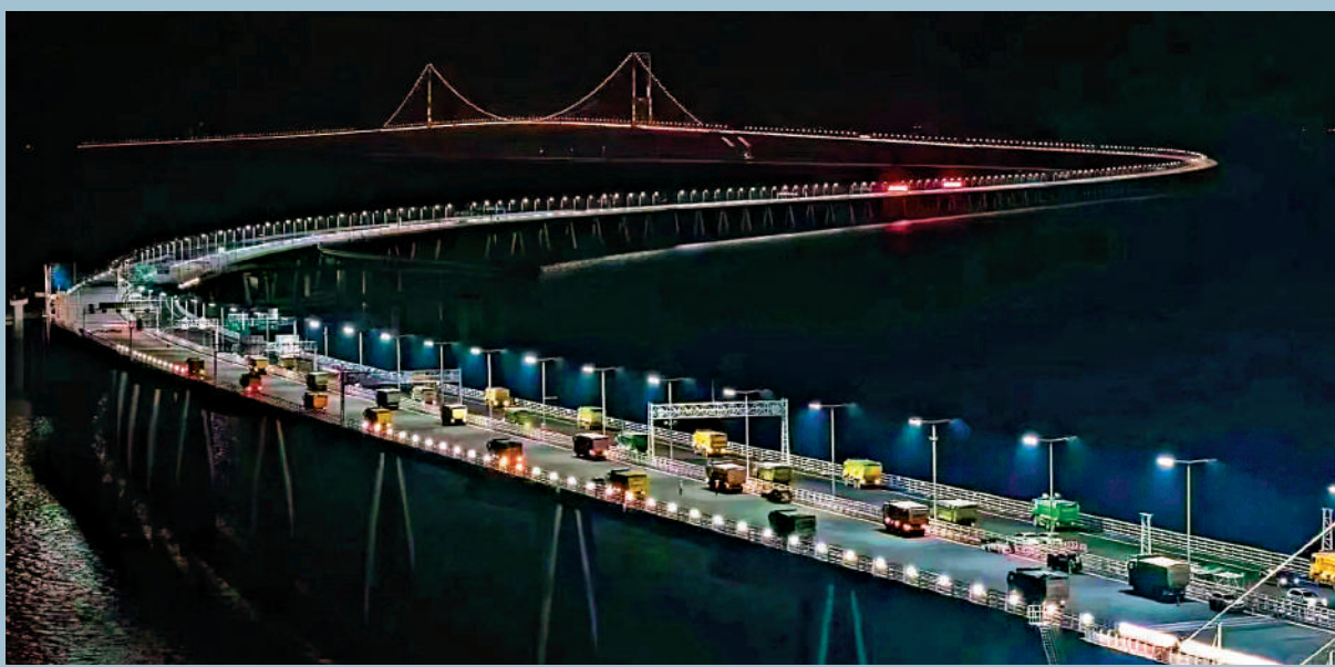
▲深中通道通車前的橋樑「荷載試驗」階段，覆蓋海中橋樑全部結構類型，試驗將持續到4月17日。
