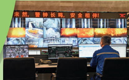
▲中控室內的工作人員實時監控焚燒爐內作業情況。
