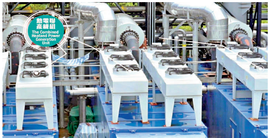
▲O·PARK1利用廚餘經厭氧消化技術產生甲烷，由熱電聯產機組發電。
