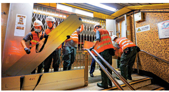
▲港鐵在黃大仙站部分出入口安裝防洪板，減低水浸機會。
