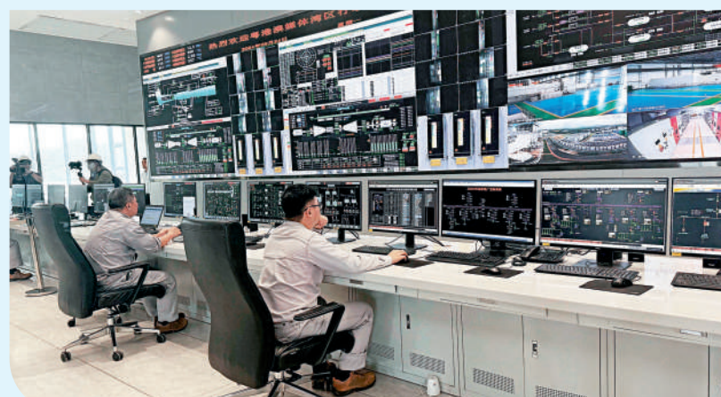
▲廣東粵電花都天然氣熱電有限公司控制中心內，工作人員監視運行數據。大公報記者盧靜怡攝
