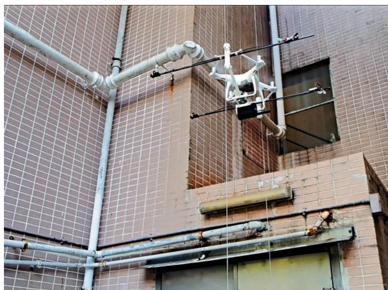
▲煤氣公司不定期利用無人機檢查大廈外牆的煤氣管鏽蝕情況。
