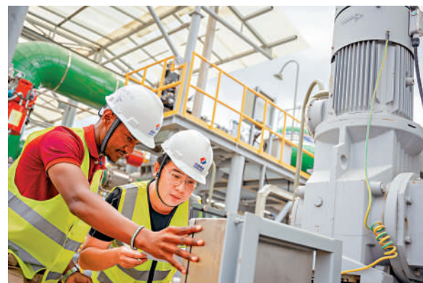
▲中企施工人員在位於肯尼亞納庫魯市的索西安地熱電站項目建設現場檢查發電設施。新華社
