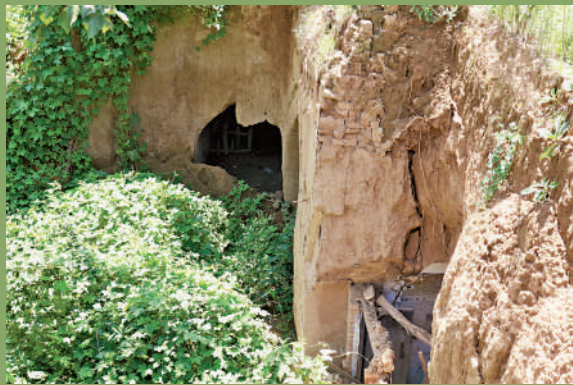
▲因年久失修無人居住而坍塌的地坑院。
