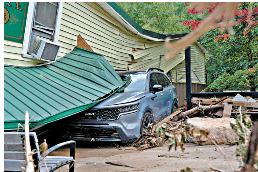
▲北卡一處房屋倒塌，汽車損毀。法新社
