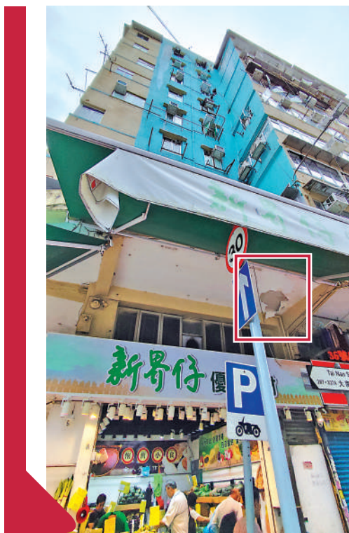
▲深水埗大南街335號建築物，簷篷頂牆壁有外牆剝落。大公報記者古倬勳攝
