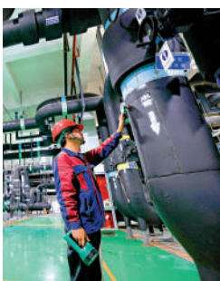
▲8月29日，工作人員在貴州貴安超算中心數據機房附屬設施內工作。
