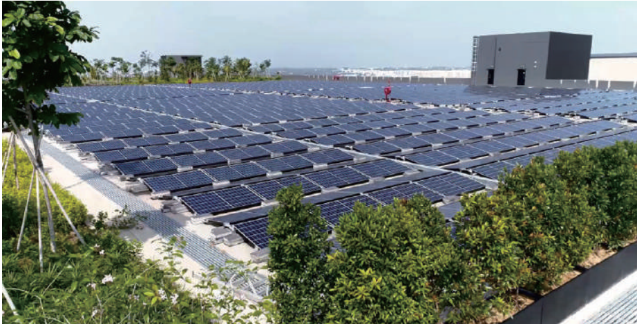
▲Megahub倉庫頂部鋪設了超過3000塊太陽能板。
