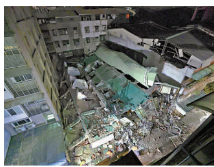
▲新北市一處工地下室6日開挖，造成工地兩側的建築物傾斜、倒塌。
