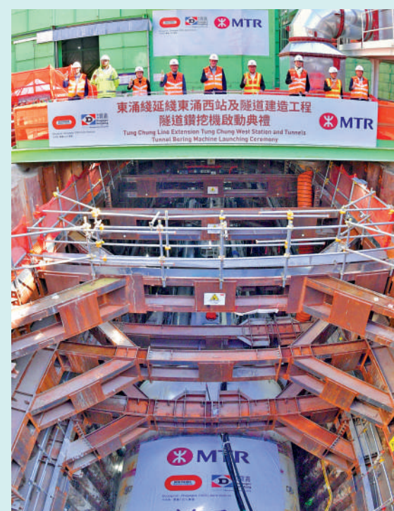
▲港鐵東涌綫延綫項目的東涌西段隧道工程，昨日於隧道豎井工地舉行鑽挖機啟動禮，標誌隧道建造工程踏入關鍵階段。
