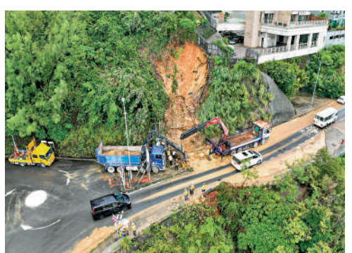
近年極端天氣頻發，本港多區曾發生嚴重山泥傾瀉意外。
