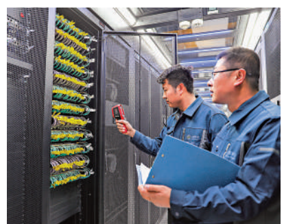
▲1月6日，中國移動數據中心甘肅慶陽巡檢。 新華社
