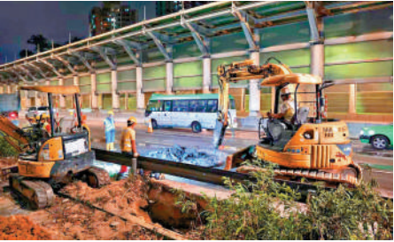
▲屯門公路前日深夜爆水管，水務署昨晚表示，工程團隊正加緊搶修，爭取今早交通繁忙時段前重開。
