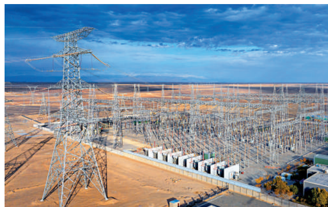
▲新疆是我國西電東送的重要送端。圖為位於新疆哈密市的哈密南—鄭州±800千伏特高壓直流輸電工程的天山換流站。新華社
