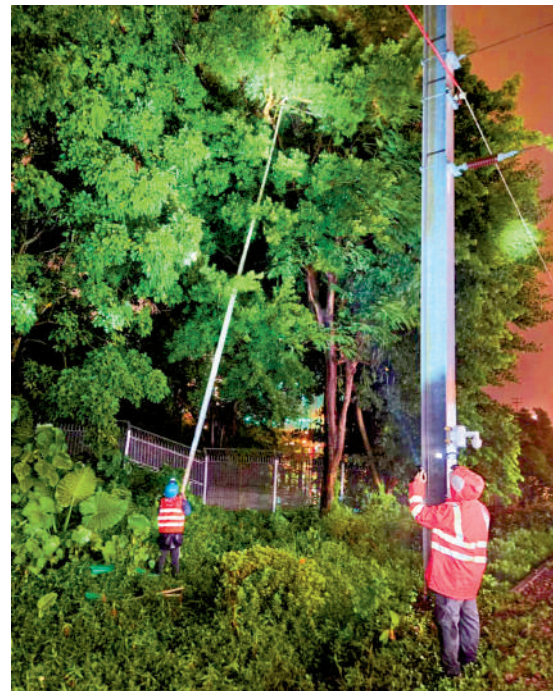
▲職員檢視樹木情況，以防塌樹影響交通。
