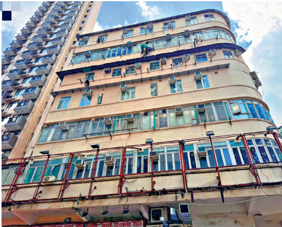
▲太子道西127至139號是由四幢舊樓組成的建築群，涉及7個街號，要處理政府的維修命令，需要先成立7個法團。
