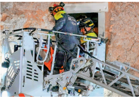
▲消防員3日救援被困在廢墟中的工人。美聯社
