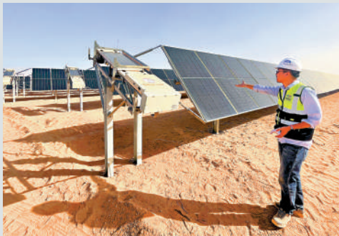
▲中國光伏企業積極開拓非洲市場。圖為在埃及南部阿斯旺省沙漠中的光伏電站。
