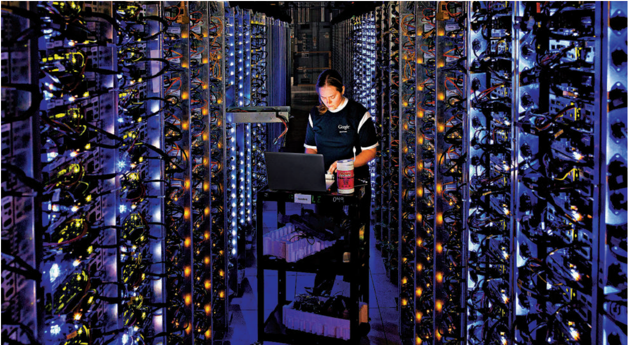
▲美國基礎的電力供需短期暫看不到緊張的跡象，但中長期，數據中心建設集中地區確實面臨供給短缺。
