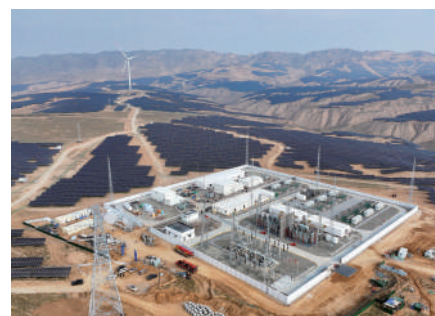
▲寧夏電投永利（中衛）300萬千瓦光伏綠電項目1號升壓站。
