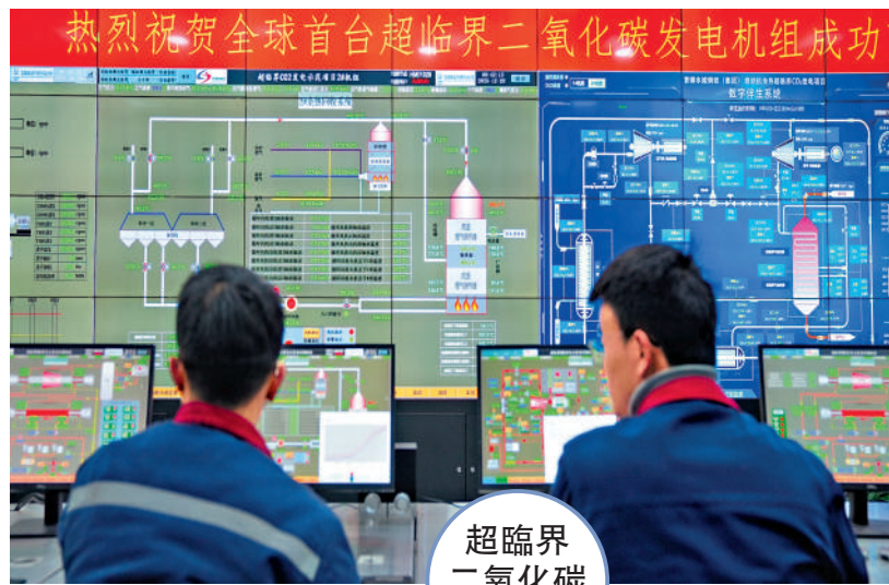
▲2025年12月20日，全球首台商用超臨界二氧化碳發電機組「超碳一號」在貴州六盤水首鋼水鋼集團成功投入商業運行。圖為工作人員在「超碳一號」智控中心工作。新華社
