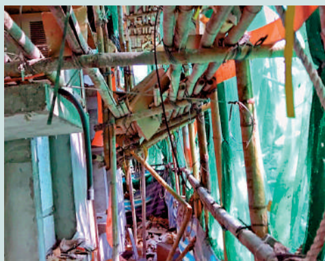
▲宏福苑窗戶被發泡膠封閉，成為大火蔓延的元兇之一。
