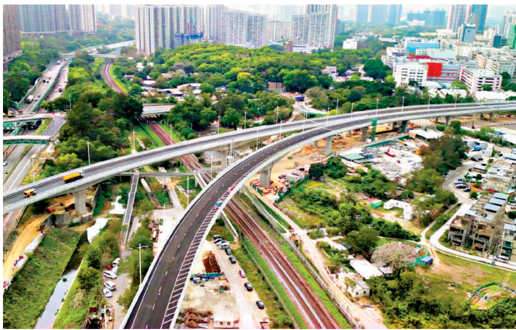
▲粉嶺繞道（東段）首次採用「橋樑轉體施工技術」，預計將於本月底或5月初開通。
