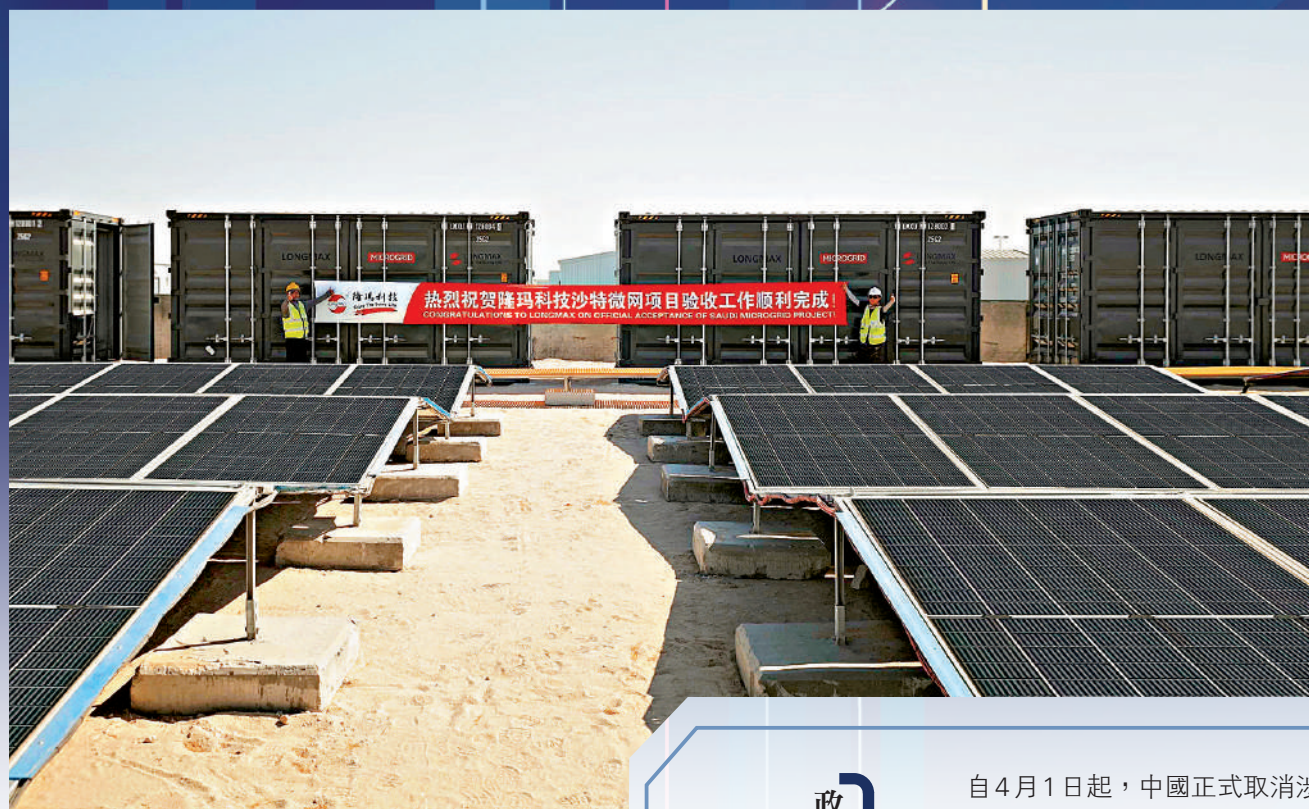
隆瑪科技的光伏產品遍布全球，在沙特的混合微網項目驗收。隆瑪科技供圖
