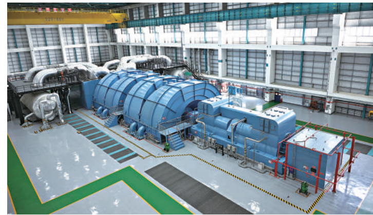
▲中廣核廣東太平嶺核電項目1號機組汽輪發電機。新華社
