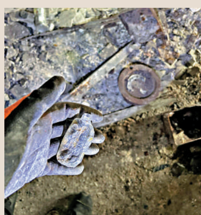
▲宏新閣九樓住戶梁先生的單位損毀嚴重。住戶提供
