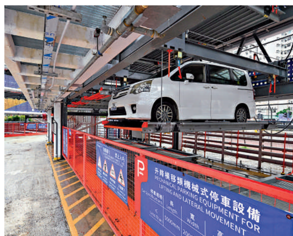
▲油麻地海泓道短期租約停車場的自動泊車系統，可通過載車板垂直升降和左右橫移，移動車輛至地面存取。
