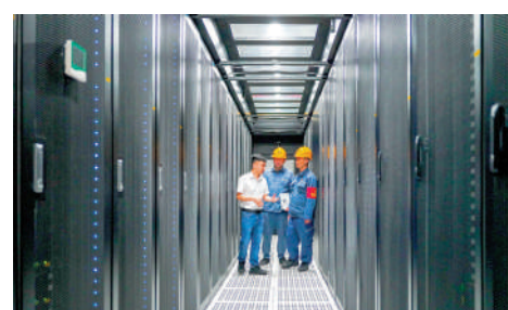
▲工作人員走進廣東移動粵東數據中心機房了解企業用電情況。受訪者供圖
