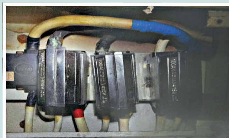
▲梁偉欽表示，涉事商戶的配電箱安裝並不穩妥，膠布氧化，露出銅線，一碰到水分，容易引發爆炸。
