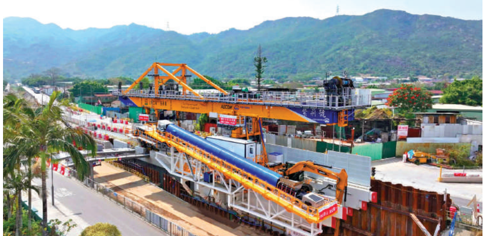
▲「紫荊號」單邊挖掘U型盾構機整合「支撐、挖掘、推進、預製件安裝與回填」五大工序，實現全機械化、一體化地面施工，有效消除高空作業風險。
