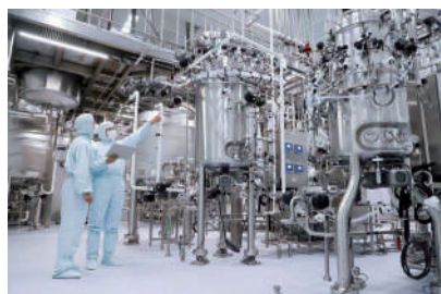
▲齊魯製藥生物製藥3400車間操作員正在現場巡檢。
