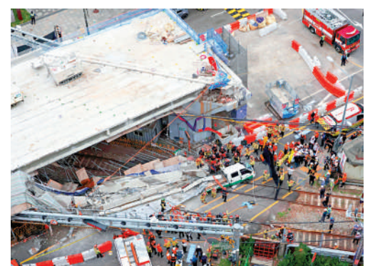
▲韓國消防和救援人員26日在高架橋坍塌事故現場展開搜救。美聯社
